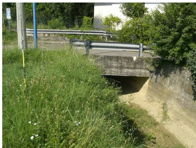
Foto 8.1: vista verso monte, tra le sezioni SP_PS_020 e SP_PS_021. Note: Ponte in VIA SOLDANI.
