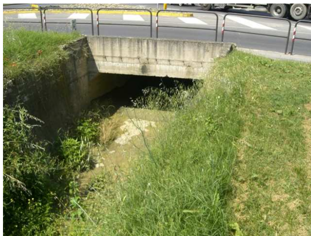
Foto 7.1: vista verso valle, tra le sezioni SP_PS_028 e SP_PS_027. Note: Ponte in VIALE LUIGI CADORNA.
