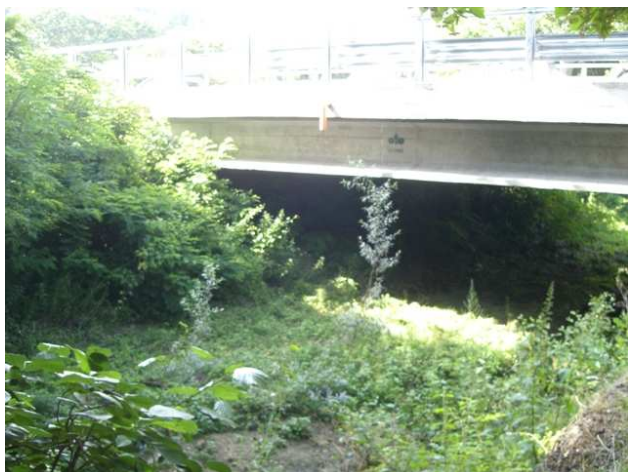
Foto 6.2: vista verso monte, destra idraulica, tra le sezioni GI_PS_054 e GI_PS_055. Note: Ponte in VIA DELLA SUGHERELLA.
