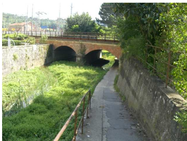
Foto 4.1: vista verso monte, tra le sezioni GI_PS_038 e GI_PS_039. Note: Ponte ferroviario FIRENZE-ROMA.
