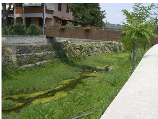
Foto 3.1: vista verso valle, tra le sezioni CA_PS_171 e CA_PS_172. Note: Passerella pedonale.
