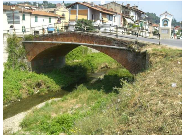
Foto 8.2: vista verso valle, tra le sezioni DO_PS_145 e DO_PS_146. Note: sulla STRADA PROVINCIALE DI MONTEVARCHI.
