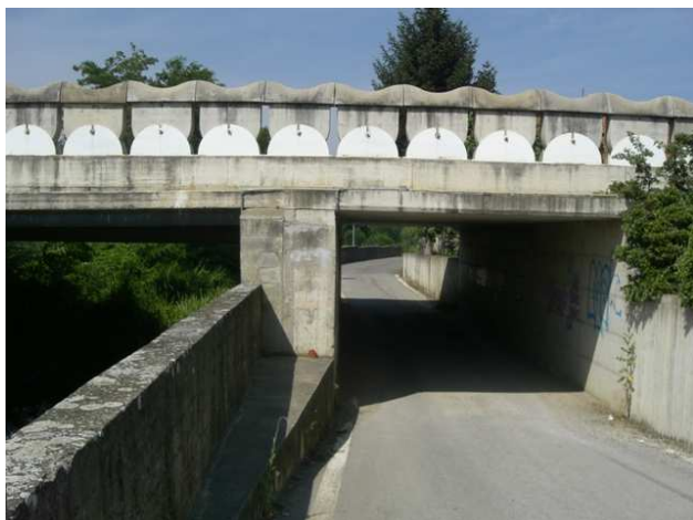
Foto 1.4: vista verso valle, destra idraulica, tra le sezioni GI_PS_013 e GI_PS_012. Note: Nuovo ponte.
