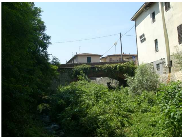
Foto 3.2: vista verso monte, tra le sezioni CPM_PS_009 e CPM_PS_010. Note: Ponte in VIA GIUSEPPE VERDI.
