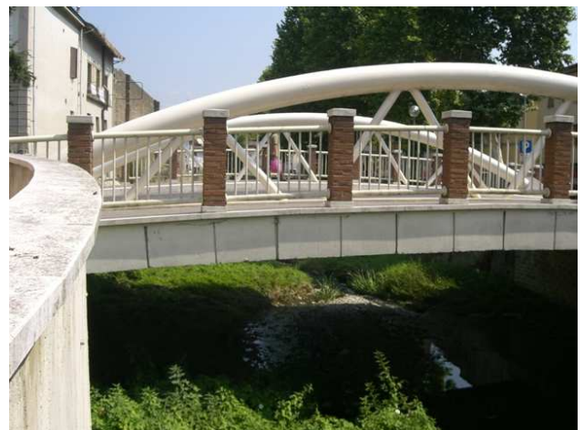
Foto 3.2: vista verso valle, sinistra idraulica, tra le sezioni DO_PS_112 e DO_PS_111. Note: Ponte in VIA MARCONI.
