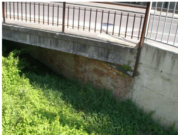
Foto 7.2: vista verso monte, tra le sezioni OR_PS_020 e OR_PS_021. Note: Ponte in VIA PACINOTTI.
