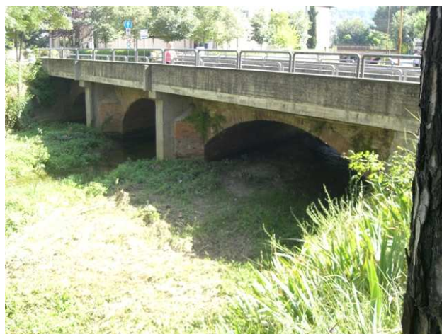
Foto 3.1: vista verso monte, tra le sezioni GI_PS_034 e GI_PS_035. Note: Ponte in VIA AMMIRAGLIO BURZAGLI.
